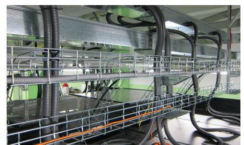
Природна вентиляція кабелю
